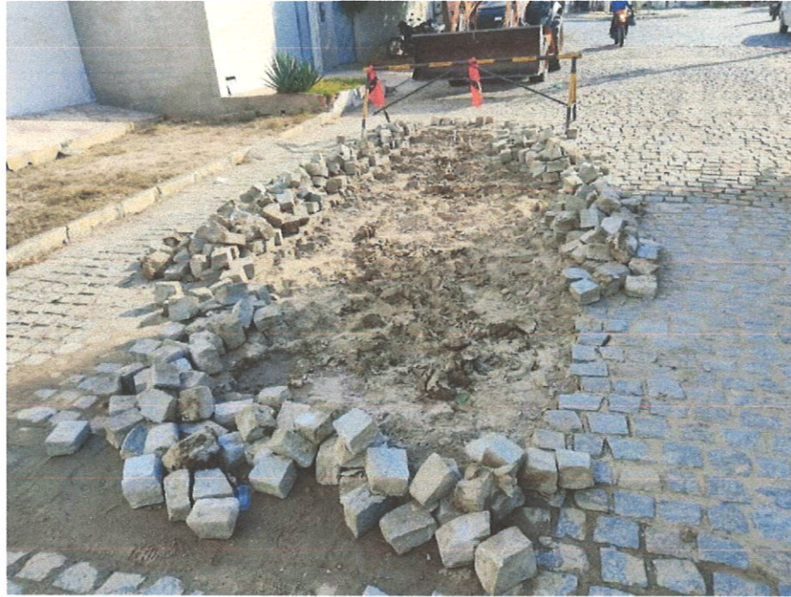
Foto 09- Reassentamento de paralelepípedo, rejuntamento com argamassa/ Aterro com pó de brita – areia
